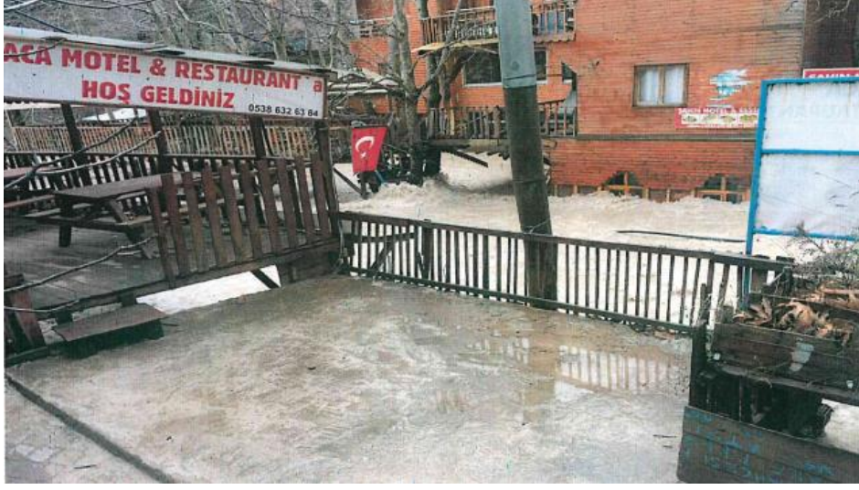
Şekil 4.4. Kapuz Deresi taşkınının mahalledeki evlerin zemin katlarının taşkın suyuyla dolması
